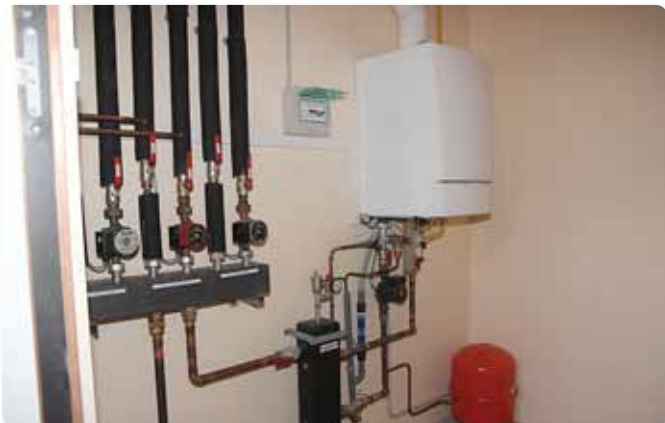
Chaufferie « Centre de loisirs »
