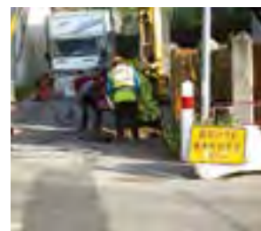
► De nombreuses ruptures de canalisations
